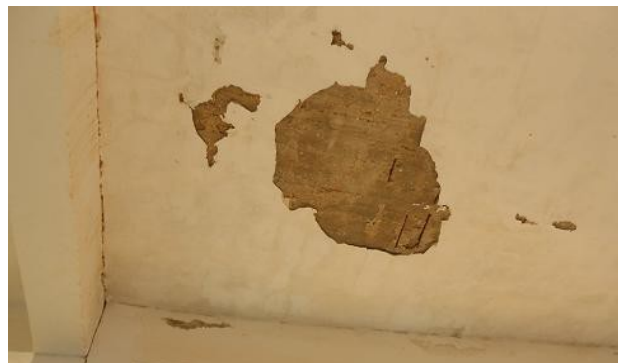
Etat des plafonds
