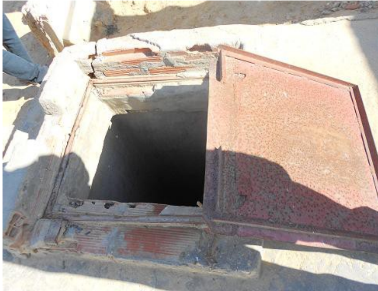
Citerne stockant l'eau pour les besoins de l'école
