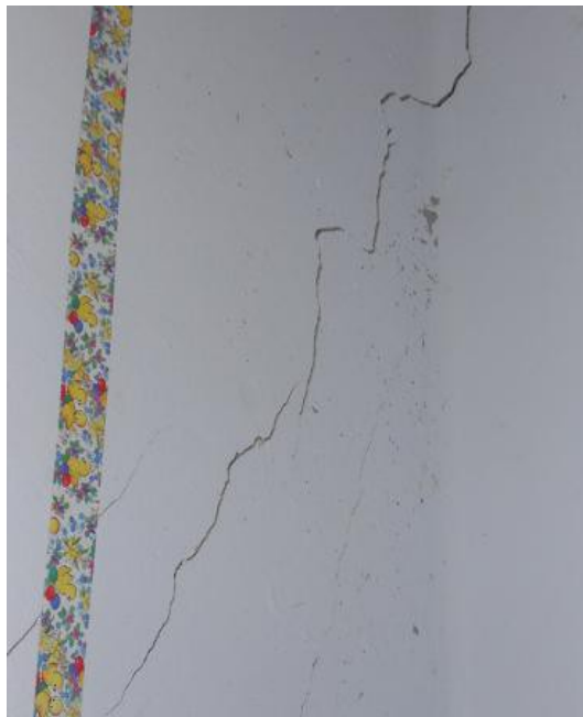
Etat des murs et du plafond dans la salle des élèves de la classe préparatoire (Élèves de moins de 6 ans)
